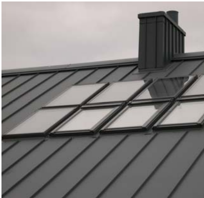
Ovenlys og solfangere.
