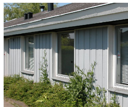
Den sydvendte facade før energirenovering (Foto Henrik Tommerup, DTU Byg)
