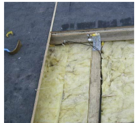
Indbyggede fugtfølere i tagkonstruktionen
